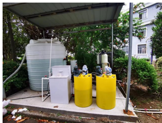
一体化污水处理设施
