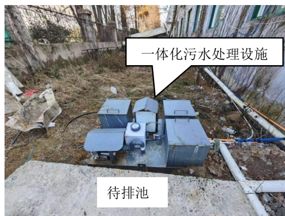
一体化污水处理设施及待排池
